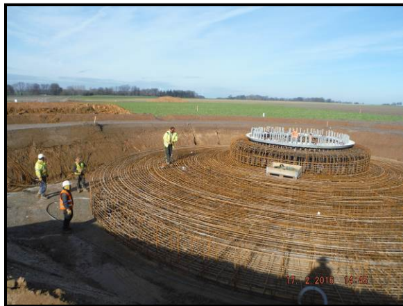
Ferraillage d'une fondation d'une éolienne du parc de Falfosse & Ramonts © D. Carpentier
