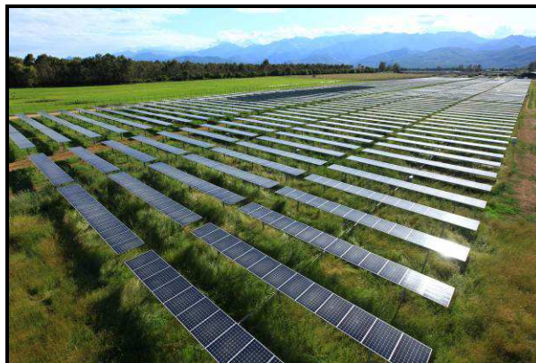
Centrale solaire photovoltaïque de Porette de Nérone (Haute-Corse). © GDF SUEZ Camille Moirenc
