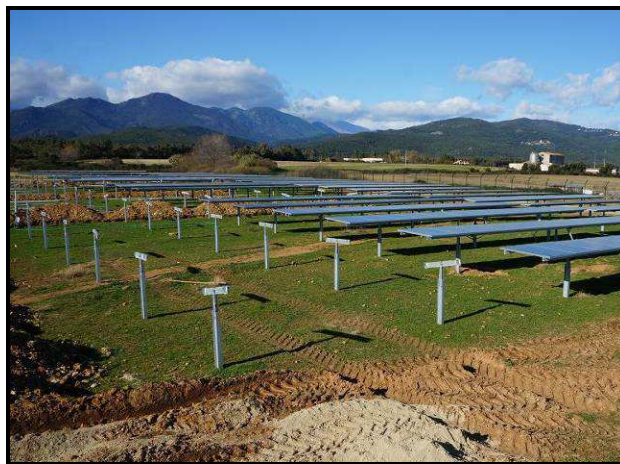
Montage des panneaux photovoltaïques d'une centrale de La Compagnie du Soleil (Porette de Nérone – Corse)
