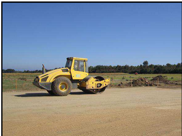
Terrassement d'un site de La Compagnie du Soleil (Porette de Nérone – Corse)
