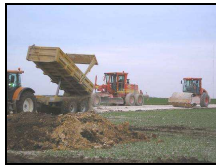
Création d'une piste d'accès sur un parc éolien de La Compagnie du Vent
