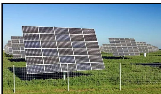
Exemple de centrale au sol avec panneaux solaires sur trackers © iStockphoto
