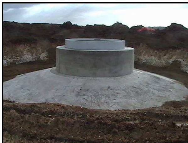
Fondation sur laquelle sera boulonnée la tour d'une éolienne du parc du Chemin des Haguenets
