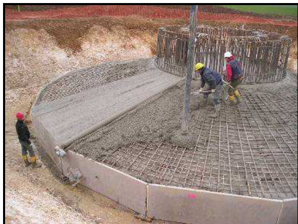
Coulage du béton d'une fondation d'une éolienne du parc du Chemin des Haguenets
