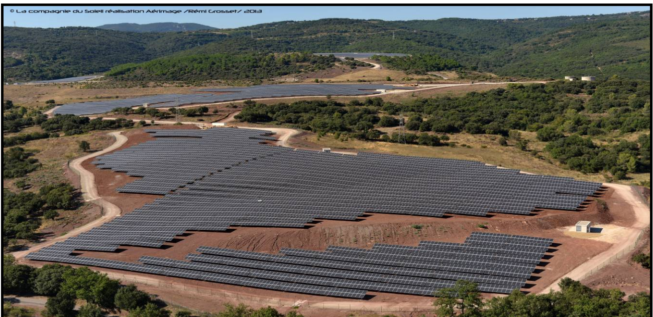
Centrale solaire photovoltaïque de Le Bosc et Soumont © Rémi Grosset - AERIMAGE
