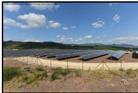
Centrale solaire photovoltaïque de Le Bosc et Soumont © Rémi Grosset - AERIMAGE
